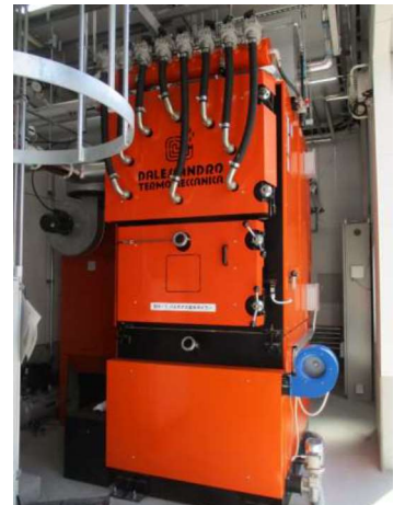
バイオマスボイラー(B&G 海洋センター設置)
